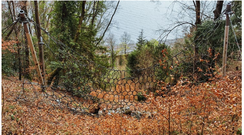
Abb 1 Oberhalb Chillon schützt ein hybrides System aus Schutzwald und Netzen die darunterliegenden Verkehrswege vor Steinschlag. Foto: Benoît Loup
